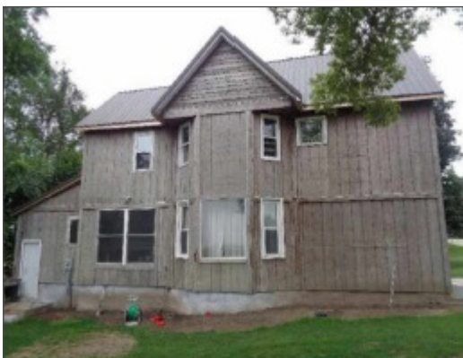
Antes de las reparaciones
